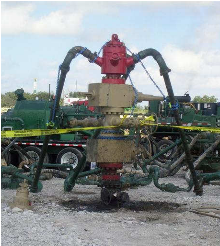
Tête de puits de fracturation hydraulique
